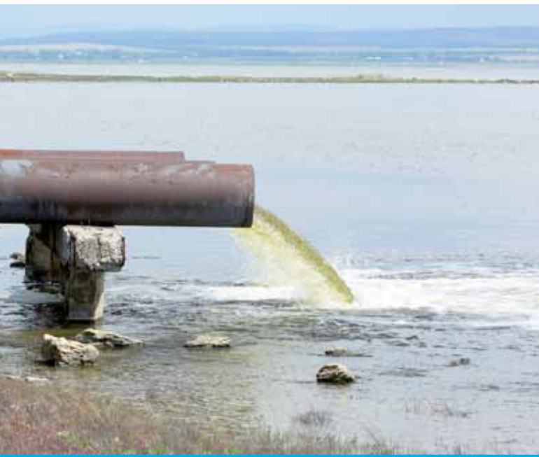
Rejet des eaux usées
